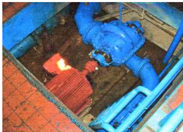
Gambar 1. Pompa Intake Kampung Koto
