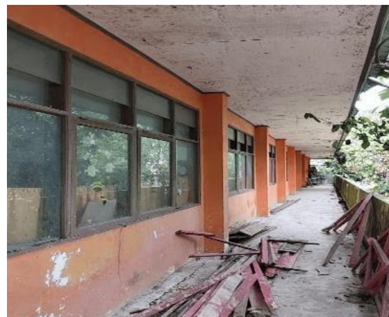
Gambar 1. Kondisi SD Pasca Banjir
