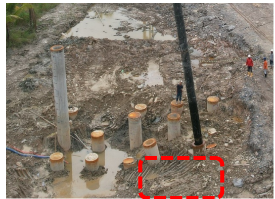
Gambar 6. Dokumentasi Spun Pile A4 dan A5 yang mengalami kegagalan
