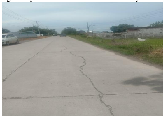
Gambar 1. Retak Memanjang Jalan
