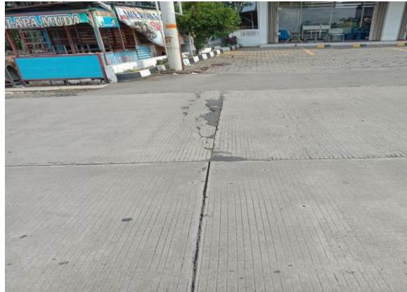
Gambar 2. Retak Melintang Jalan
