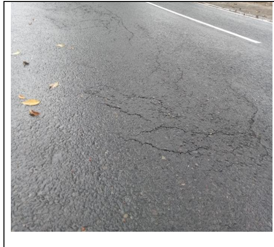
Gambar 4. Foto Aspal Retak
