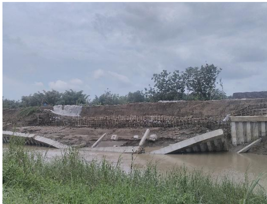
Gambar 1. Kondisi longsor awal tahun 2019
