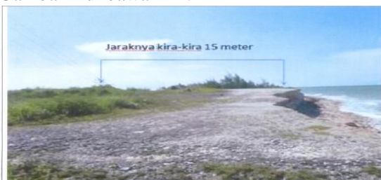
Gambar 1. Kondisi Kerusakan di Bibir Pantai Milik PT. TPPI Tuban
