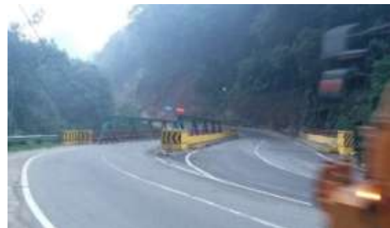
Gambar 2.1 Kelongsoran pada ruas jalan Nasional Sumbar-Riau pada saat penelitian berlangsung
