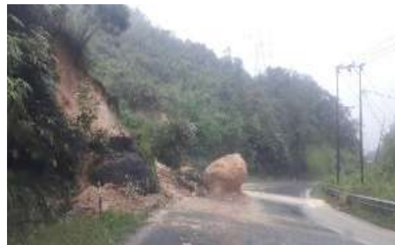
Gambar 4. Bahu dan badan jalan yang terban serta tanah tanah /batuan longsor pada ruas jalan Nasional Sumbar-Riau (3 Maret 2017)
