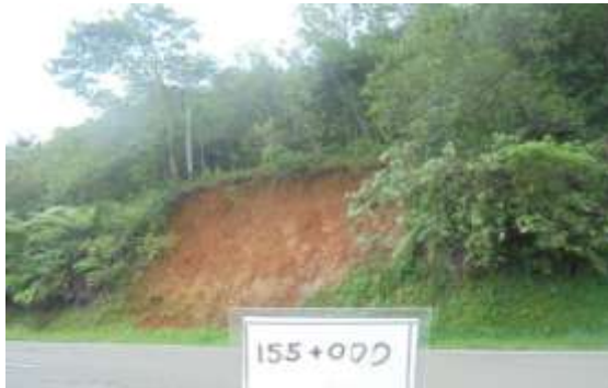
Gambar 6. Kelongsoran di titik STA 155+000
