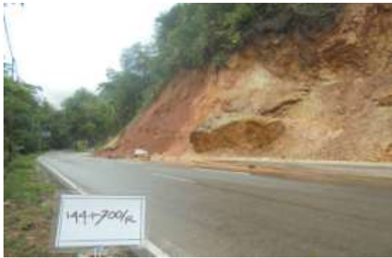
Gambar 5. Kelongsoran di titik STA 144+700
