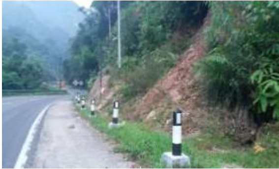
Gambar 2.3 Kelongsoran pada ruas jalan Nasional Sumbar-Riau pada saat penelitian berlangsung
