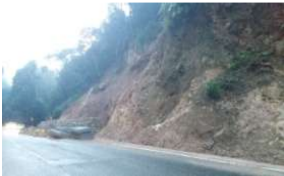
Gambar 2.4 Kelongsoran pada ruas jalan Nasional Sumbar-Riau pada saat penelitian berlangsung
