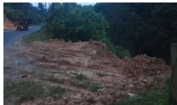
Gambar 2.2 Kelongsoran pada ruas jalan Nasional Sumbar-Riau pada saat penelitian berlangsung
